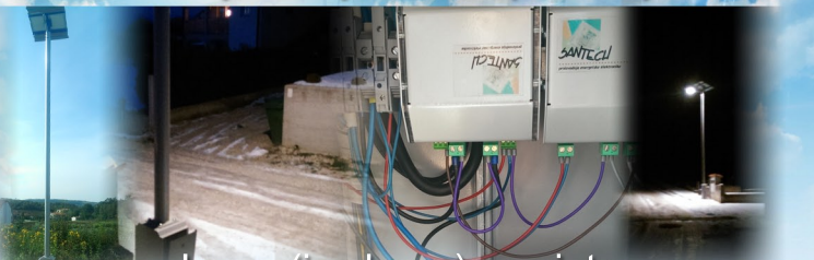
Javna (i solarna) rasvjeta
